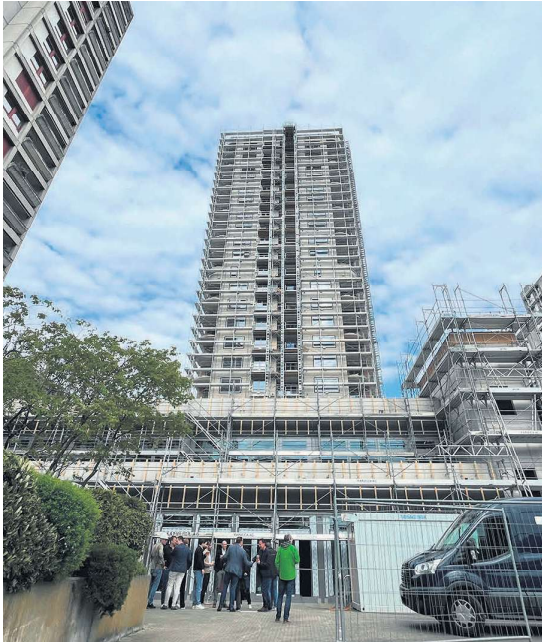
Der Rohbau des «Domus» ist fertiggestellt. Der Innenausbau hat bereits begonnen. Fotos: Valentin Zumsteg
